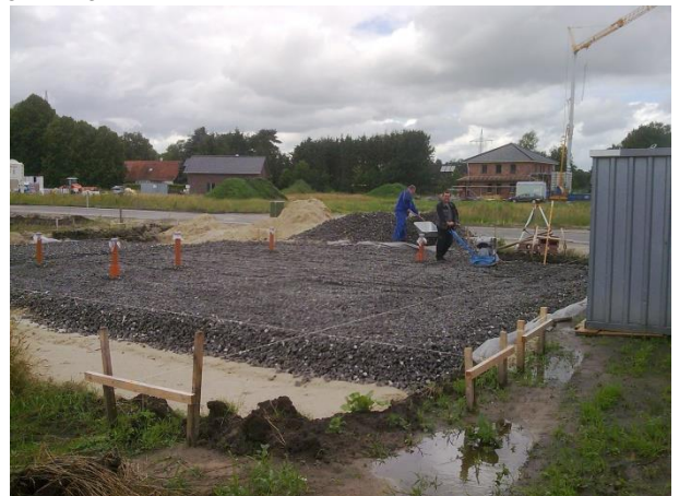
40 CM VERTEILTE SCHÜTTHÖHE BINGEN EINE 30 CM DICKE VERDICHTE WÄRMEDÄMMSCHICHT UND GLEICHZEITIG 30 CM GEGEN AUFSTEIGENDE BODENFEUCHTE
