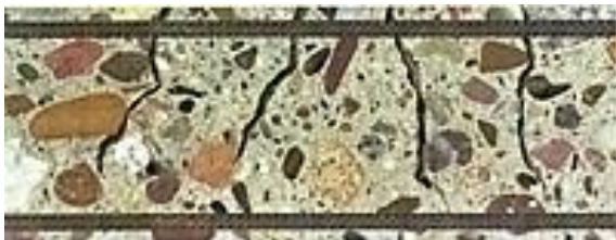
Rissbildung bei Stahlbeton, infolge Haarrisse der Bodenplatte und Korrosion des Bewehrungsstahls
